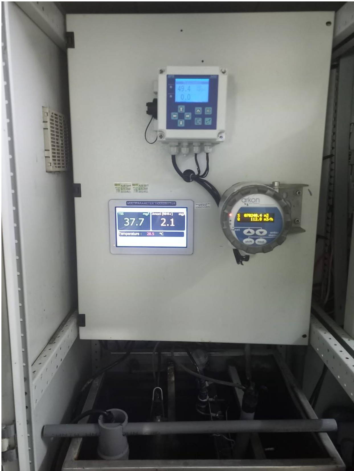
Hình 4: Màn hình hiển thị kết quả đo các thông số nước thải Trạm QTNT tự động liên tục KCN
