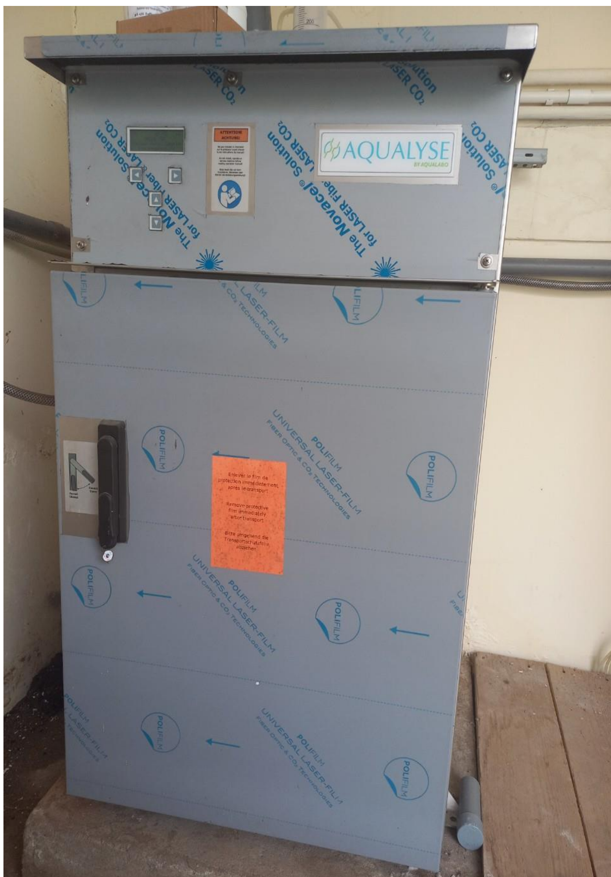
Hình 5. Thiết bị lấy mẫu nước thải tự động Trạm QTNT tự động liên tục KCN
